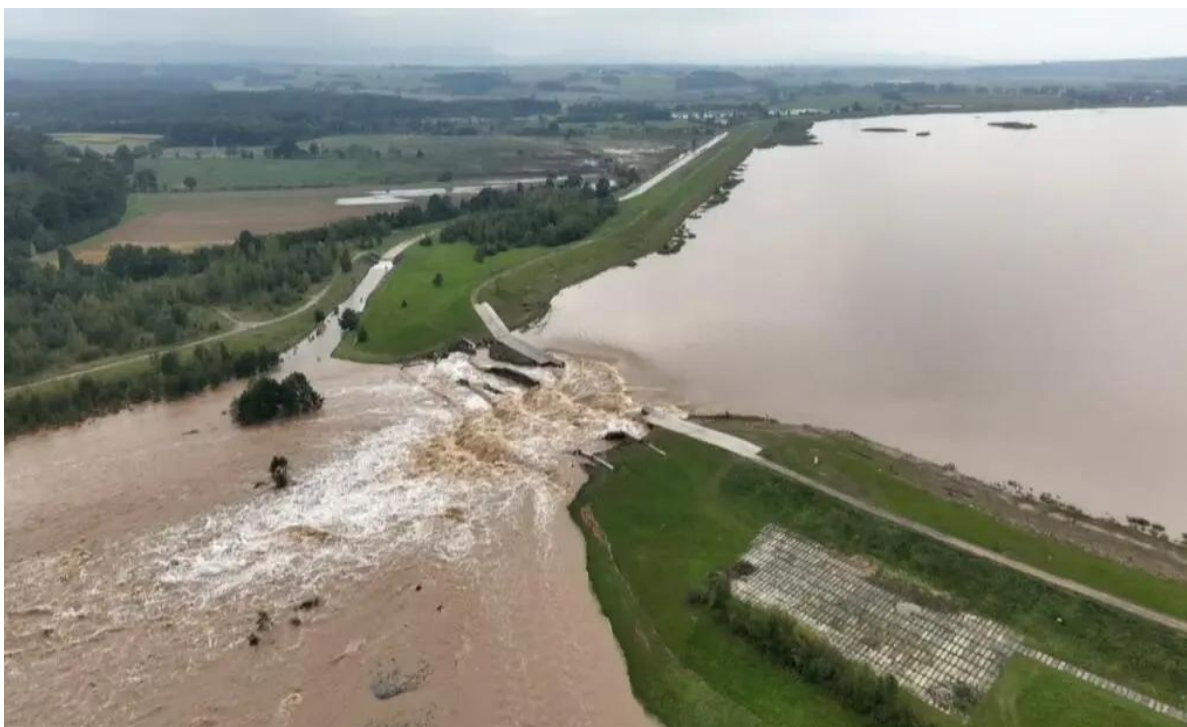
Praca przelewu powierzchniowego 2
