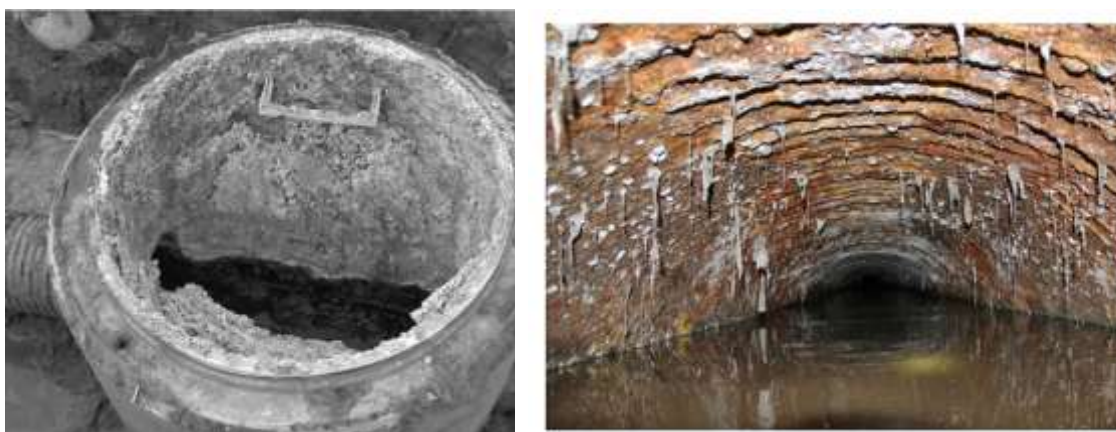
Rycina 1. Przykłady korozji siarczanowej elementów betonowych infrastruktury kanalizacyjnej
