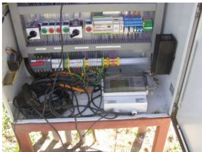
Rycina 6. Lokalizacja stacji monitorowania gazów MSMR-16 w szafce sterującej przepompowni
