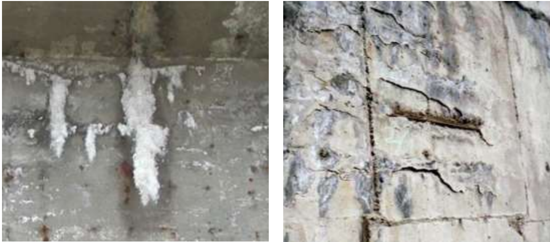
Rycina 2. Przykłady korozji ługującej elementów betonowych infrastruktury wodno-melioracyjnej
